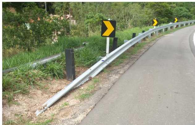
Figura 4 – Ancoragem de Defesa
